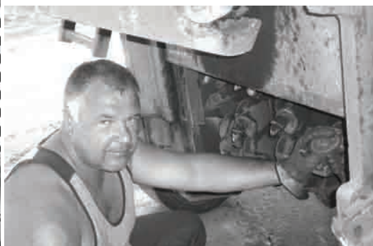
Напряжённые объёмы дорожных работ в июльскую жару под силу только людям. Таким, как оператор фрезерной машины из Смоленска А.И. Вендиктов. А вот механизмы часто не выдерживают
